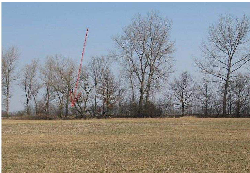
Obr. 17: Typické místo, kde se úroveň selské hráze (dílní akce 2) přibližuje nebo rovná úrovni okolního terénu
