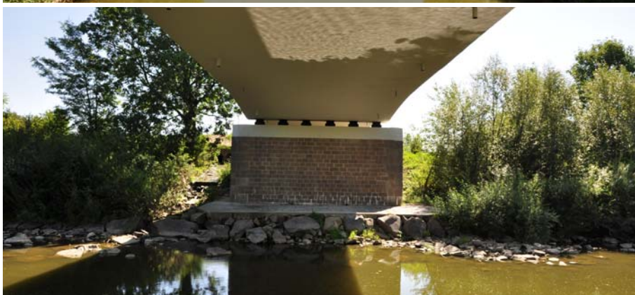
Eroze říčního dna vede k stále většímu zahlubování koryta, proto je třeba dodatečně opevňovat stavby technické infrastruktury. Zde pilíře silničního mostu u Grymova
