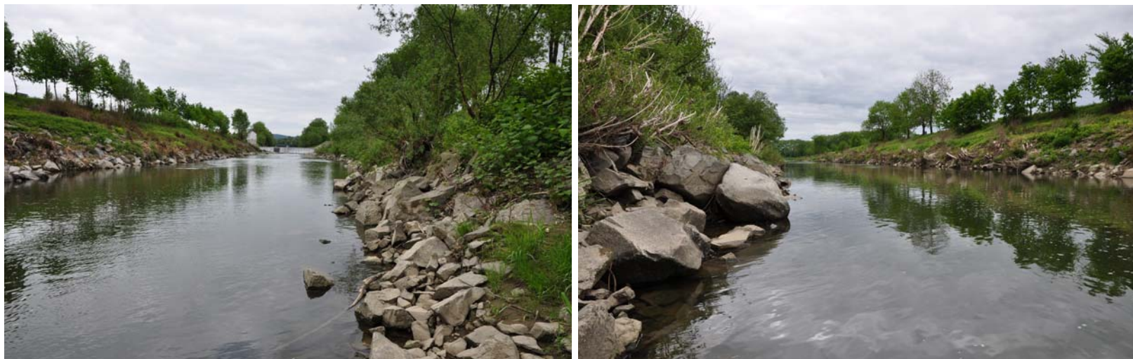
Dlouhodobě probíhající eroze dna vede k destabilizaci svahů, jež musí být opakovaně zpevňovány lomovým kamenem. V podélném profilu jsou pak proti dnové erozi budovány stupně a kamenné skluzy
