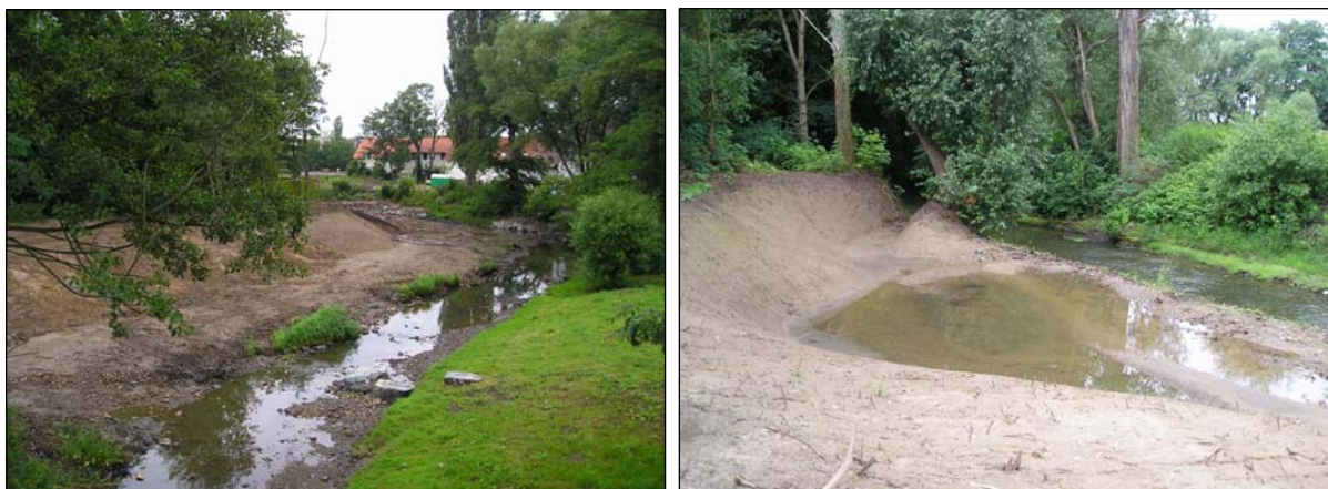
Obr. 3.42. Vytvořené bermy jsou často zaplavovány vodou a staly se tak nedílnou součástí toku (foto: Jiří Karnecki, 2009)
