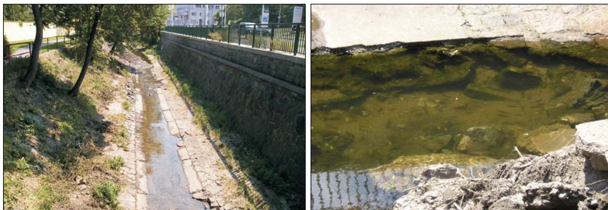
Obr. 3.43. Neutěšený stav koryta před revitalizací (foto: Jiří Karnecki, 2007)
