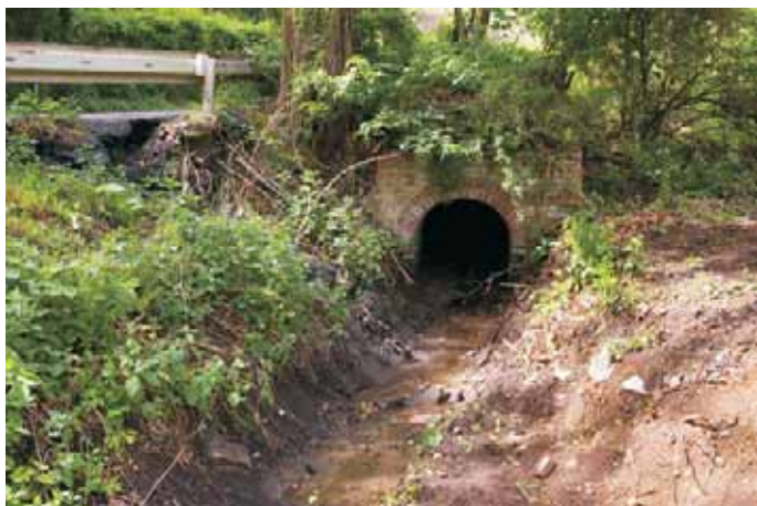
Obr.4 Stav silničního propustku před opravou, 5/2007
