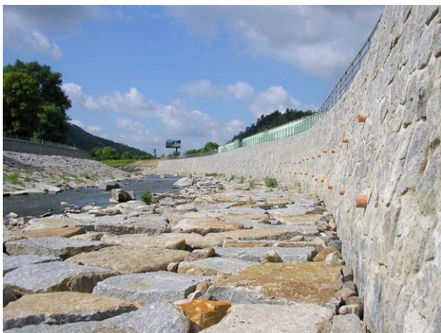
Obr. 3 Zbytečná a nákladná regulace vodního toku zrychluje odtok vody a zvyšuje energii proudu, výsledkem je ohrožení sídel níže po proudu, foto: Olgerd Pukl
