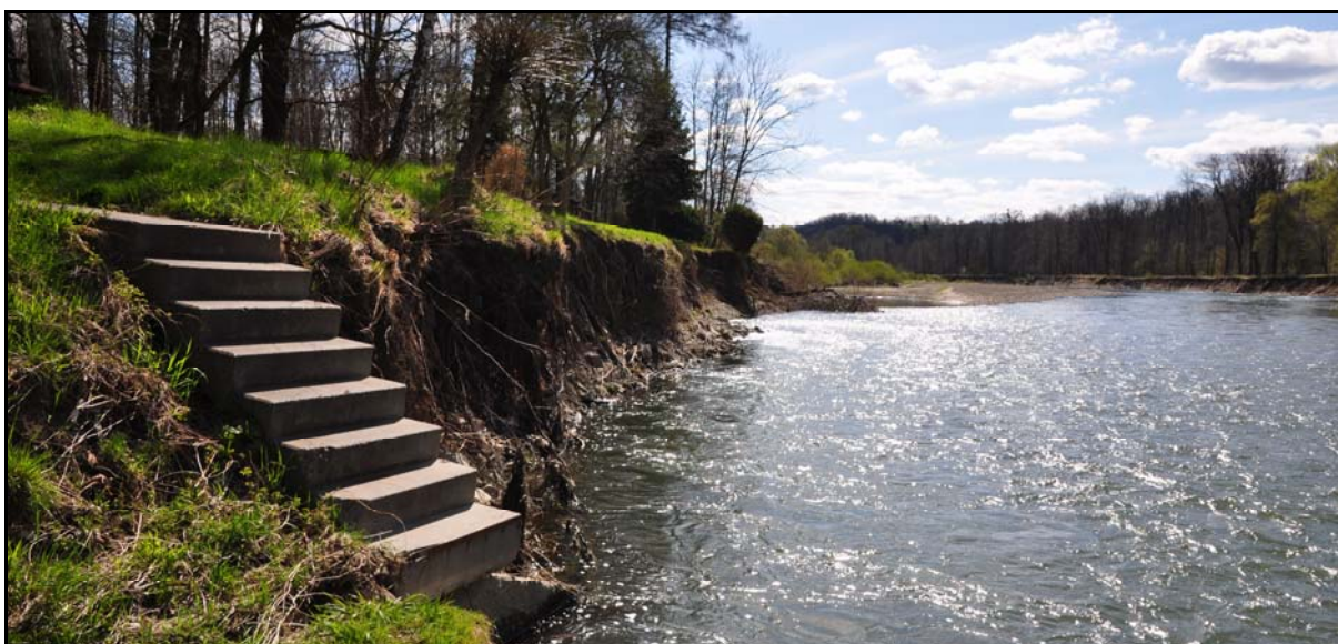
Foto 24, 25 a 26) Bečva pod Choryní – stabilizace pravého břehu kamennou dlažbou v celé výšce svahu v délce 85 m z důvodu ochrany blízké chatové zástavby, realizováno cca v r. 2010 (horní snímek). Na opevněný břeh přímo navazuje nová výtrž (povodeň 10/2020) o délce 70 m a v tomto úseku se předpokládá další vývoj břehové eroze v celkové délce 400 m, tedy až na dolní konec zpřirodněného úseku, který je vymezen balvanitým prahem
