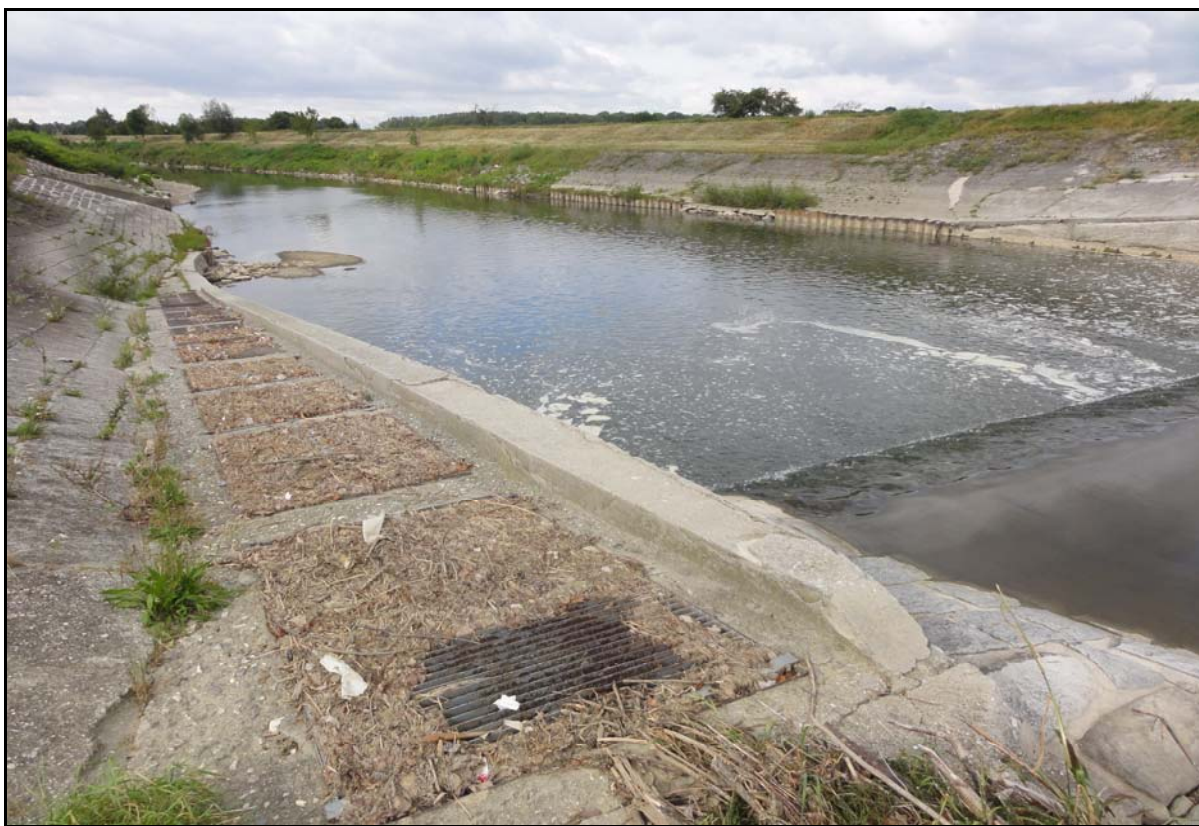
Foto 38) Jez a nefunkční rybochod Troubky – první migrační bariéra na Bečvě (ř. km 1,770)
